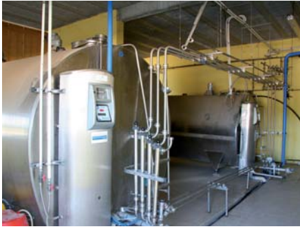
Un tank de 12 000 L et un autre de 16 000 L vont permettre de stocker la production traitée par les 4 VMS.
