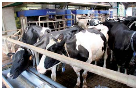
Les 3 VMS sont installés côte à côte, ouverts sur une aire commune d'accès équipée d'une porte intelligente.
